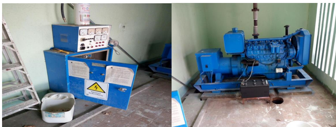
Planta de energía de la E.S.E Hospital San Antonio del municipio de Cisneros
