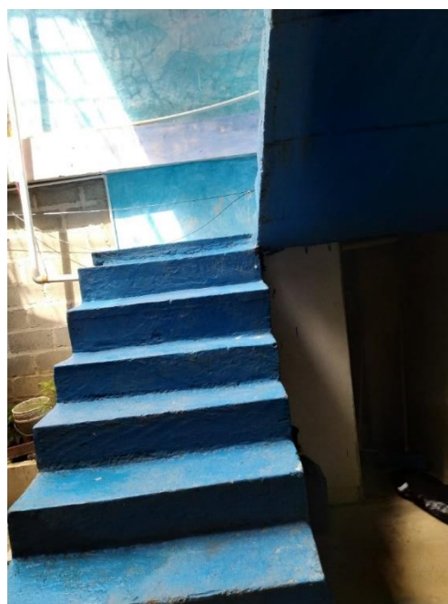
Figura 2 Escaleras sin barandas hacia el almacén de materiales
