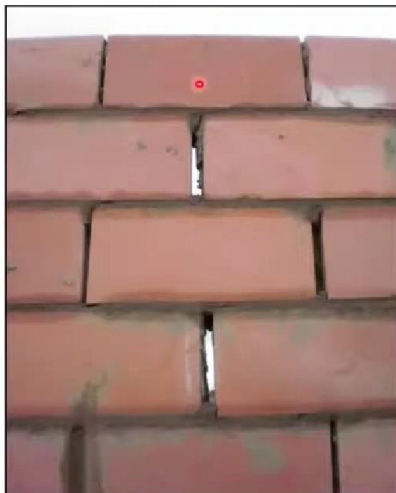
Figura 23. Ausencia de mortero de pega en juntas de mampostería
