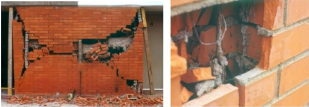
Figura 20. Insuficiente acero de refuerzo en muros de mampostería
