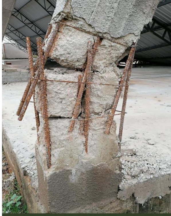
Figura 49. Despiece inapropiado del acero en una columna
