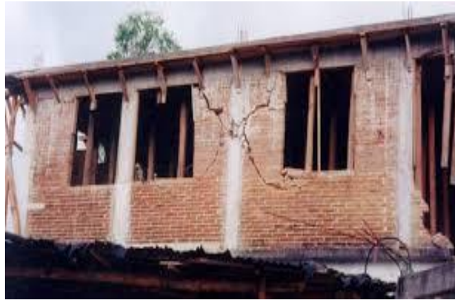
Figura 46. Falla en muros no confinados
