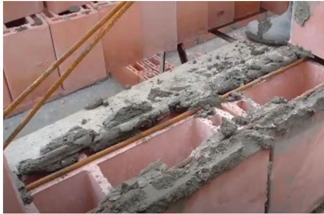
Figura 21. Inadecuada colocación de acero de refuerzo
