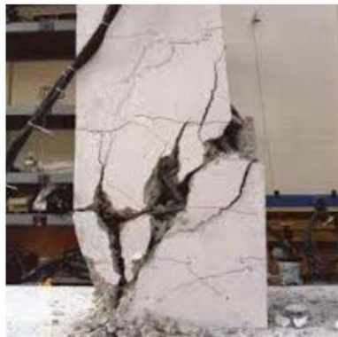
Figura 70. Falla por cortante en columnas
