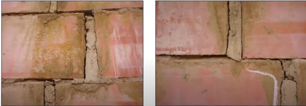
Figura 16. Mala adherencia entre el mortero y la mampostería
