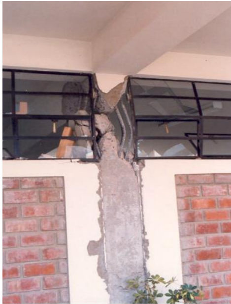
Figura 58. Falla de elemento en estructura por columna corta
