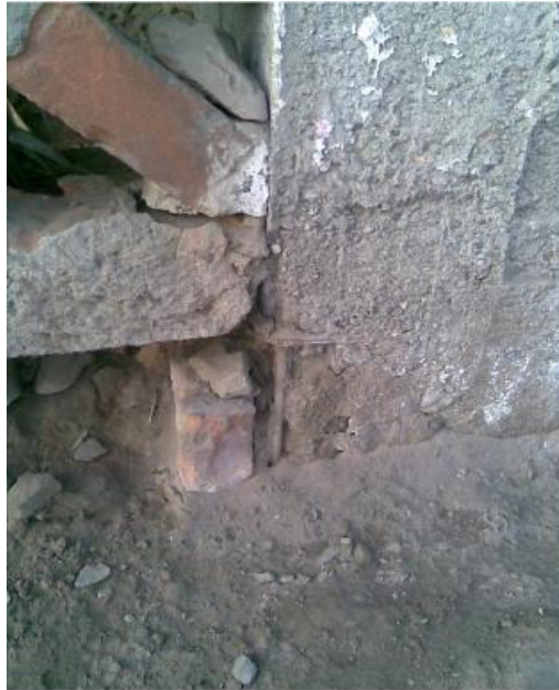
Figura 51. Disgregación en columna
