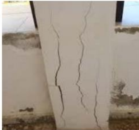
Figura 65. Falla por compresión de una columna
