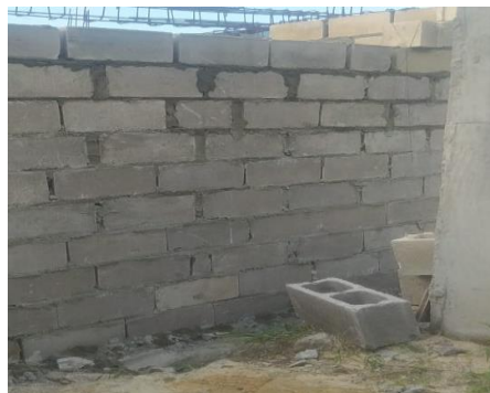
Figura 13. Mala colocación del mampuesto
