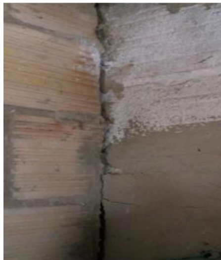
Figura 15. Falta de trabas en esquina de muro
