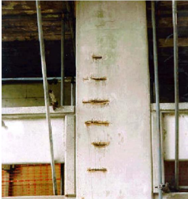
Figura 53. Corrosión del acero en columna
