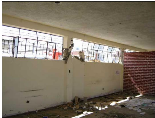
Figura 57. Falla de columna corta en una estructura
