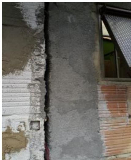
Figura 19. Separación de muro y columna
