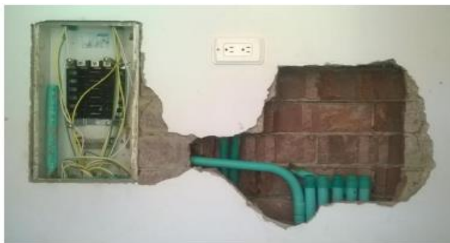
Figura 24. Regatas excesivas en la mampostería
