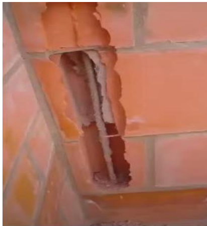
Figura 25. Ausencia de Grouting para dovelas
