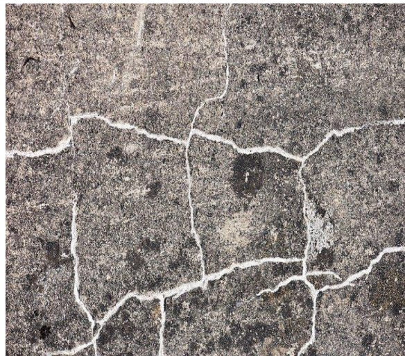
Figura 78. Efectos por curado inadecuado
