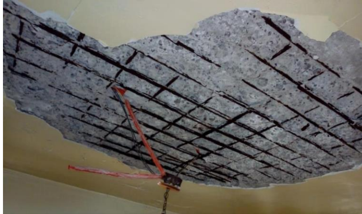
Figura 54. Corrosión del acero de refuerzo en una losa
