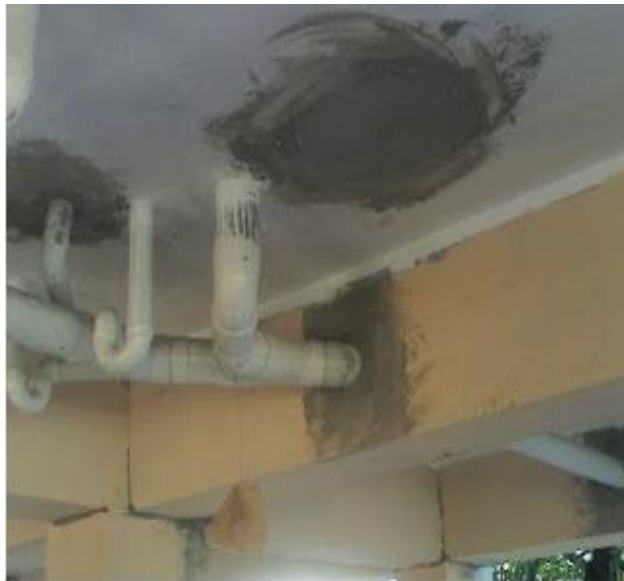
Figura 47. Tubería de desagüe embebida a viga
