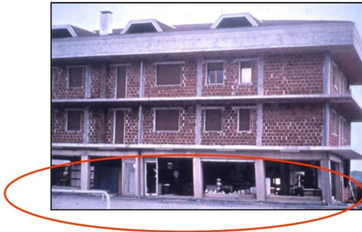
Figura 63. Piso débil en planta baja de una estructura
