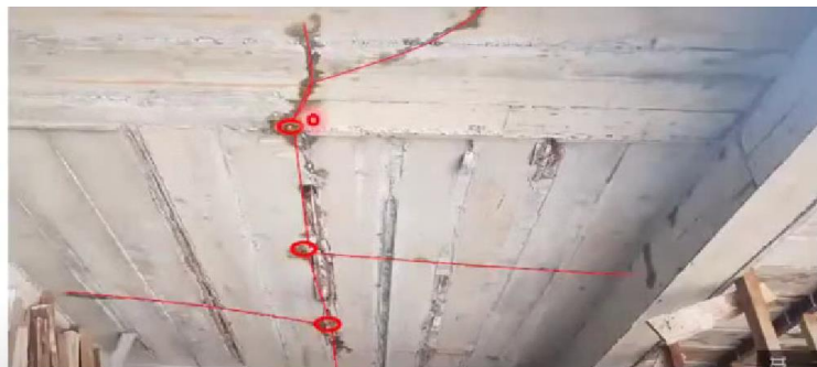
Figura 48. Grietas en losa de entrepiso por el paso de tuberías
