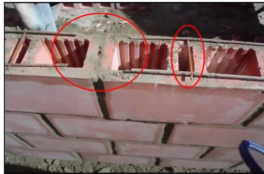
Figura 22. Discontinuidad del acero de refuerzo
