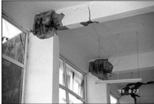
Figura 81. Falla en los nudos
