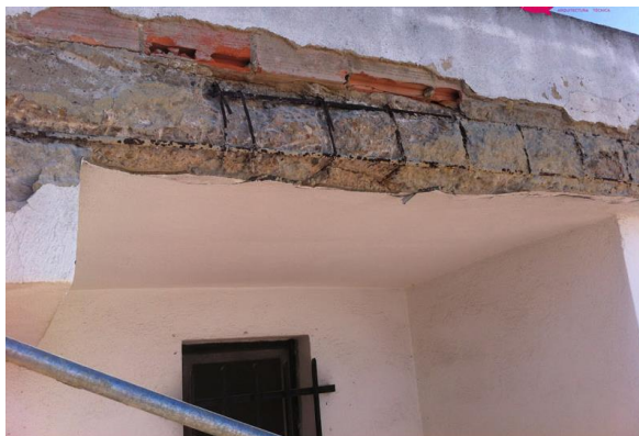
Figura 50. Despiece inapropiado del acero en una viga
