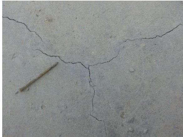
Figura 79. Fisuras por contracción
