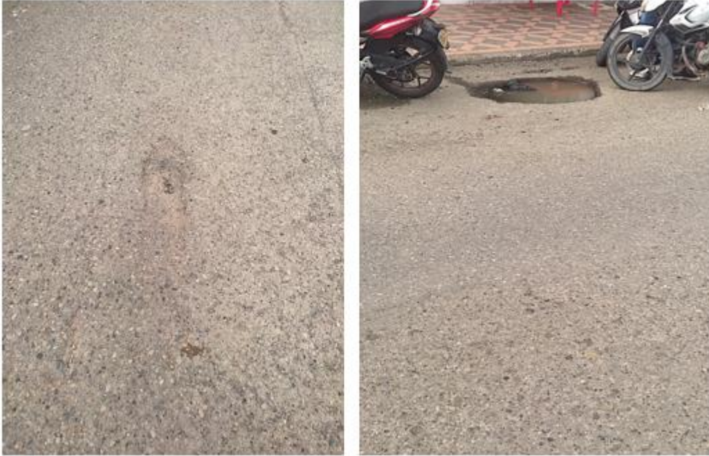
Ilustración 26. Pérdida de Agregado
