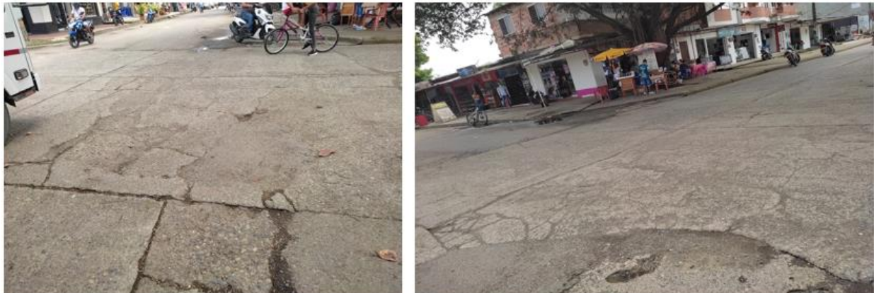
Ilustración 13. Grietas en Bloque o Fracturación Múltiple
