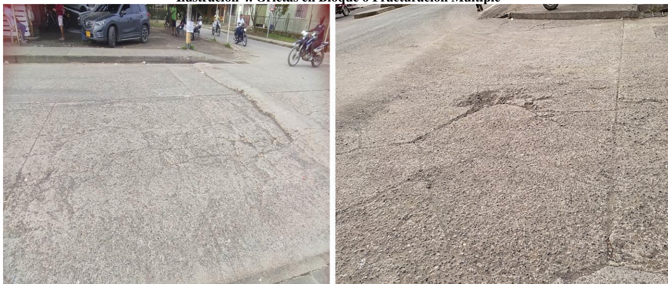
Ilustración 4. Grietas en Bloque o Fracturación Múltiple
