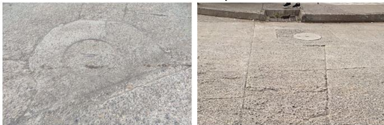
Ilustración 5. Grietas en Pozos y Sumideros
